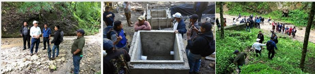
AVANCE DE PROYECTO AGUA POTABLE DE 3 COMUNIDADES (El Naranjo, Tzampetey y San Gabriel)
